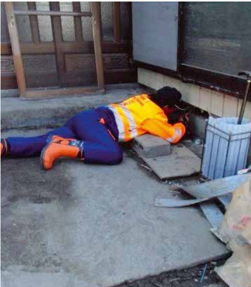
通風口から床下の泥を確認する
