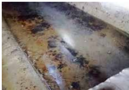
水が残って悪臭が発生する
