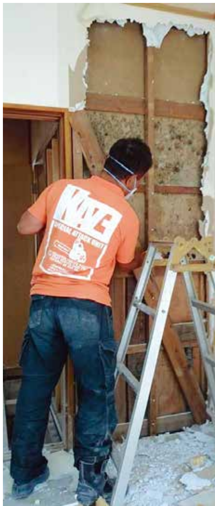
壁をはがすとカビが生えている
