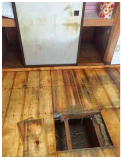
室内の被害状況も撮っておく
