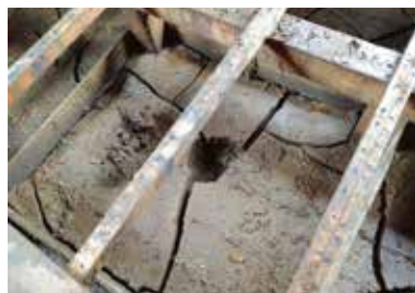
床下にたまった泥（写真③）
